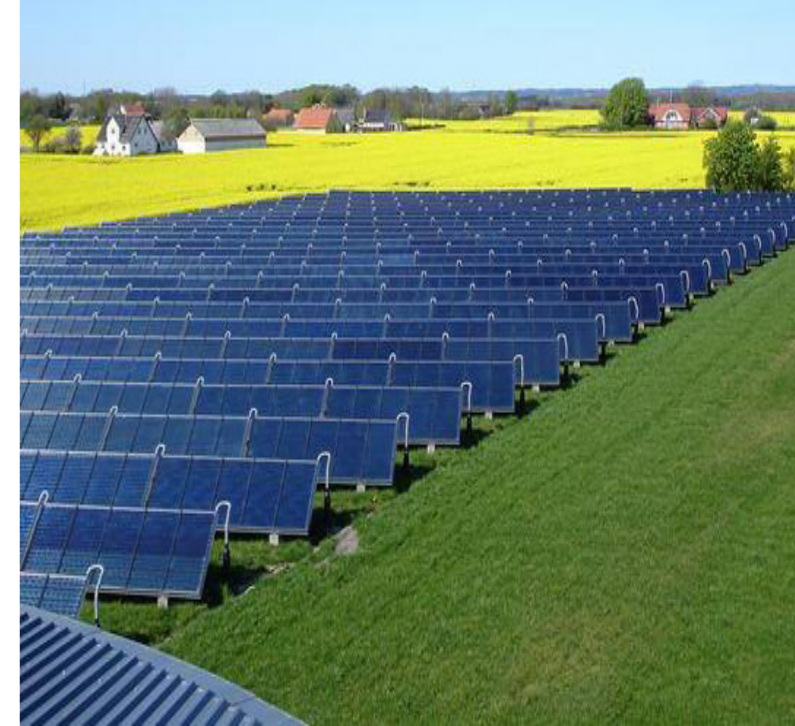
Solvarmeanlægget i Dronninglund
